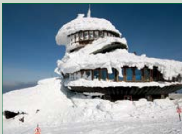
Fot. 4. Uszkodzenie konstrukcji górnego dysku stacji na Śnieżce w 2009 r.
